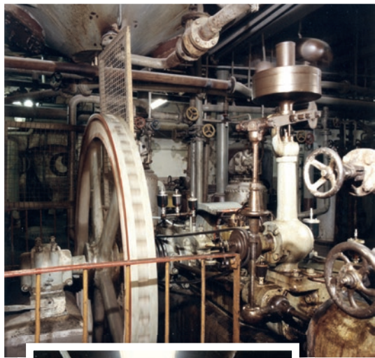
Liegende Einzylinder-Dampfmaschine für den Antrieb der Vakuumpumpe des Kondensators der Verdampfungsanlage; Baujahr 1925; Hersteller: Braunschweigische Maschinenbauanstalt.
