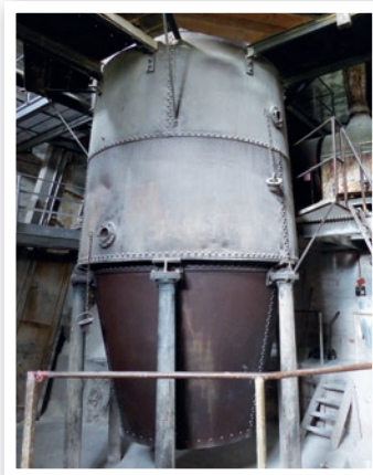
Kalkofen von 1898: Gleichzeitig mit dem Befüllen des Ofens wird unter dem Ausfalltrichter der gebrannte Kalk von Hand weggeschaufelt.
