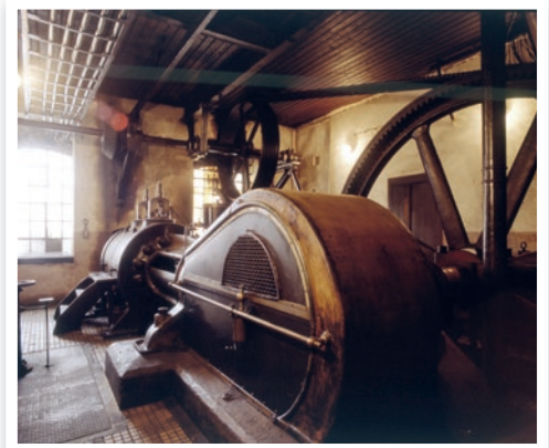
Liegende Einzylinder-Dampfmaschine mit Ventilsteuerung, Baujahr 1915, Hersteller: Braunschweigische Maschinenbauanstalt; Dampfzylinder 550 mm Durchmesser, Kolbenhub 850 mm, Arbeitsdruck 13 bar, Gegendruck 1,8 bar, Dampfverbrauch 3 t/h, Leistung 220 kW (300 PS), sechsrilliges Schwungrad mit 4.250 mm Durchmesser, Sisalseile mit 55 mm Durchmesser, Drehzahl 225 min -1 .
