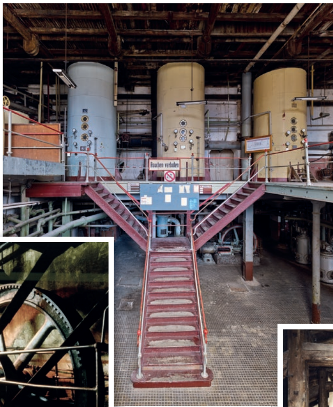
Y-Treppe im Siedehaus; im Hintergrund Verdampfer.
